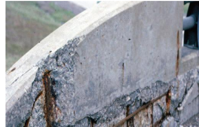
Corrosion des armatures
